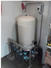
Hydrofoor met waterreservoir
